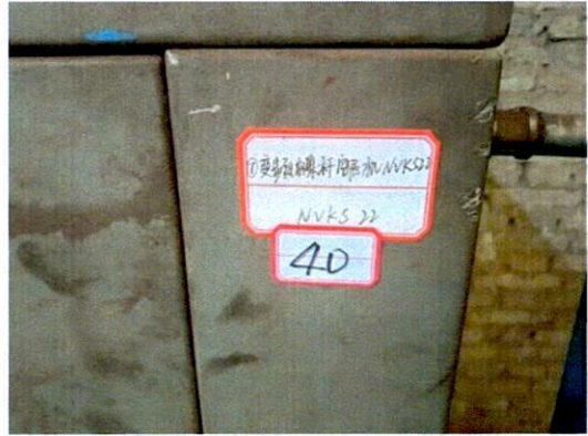
40 号设备 变频螺杆空压机:
