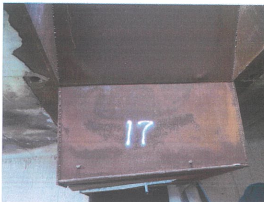
17#厂房外破碎机料仓
